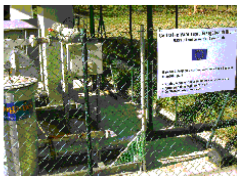
Elektrownia zasilana gazem wysypiskowym, Vila Nova de Gaia
